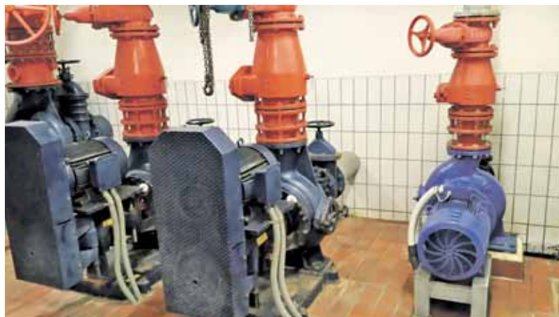
Leistungsstark: die vier Pumpen im Pumpwerk
