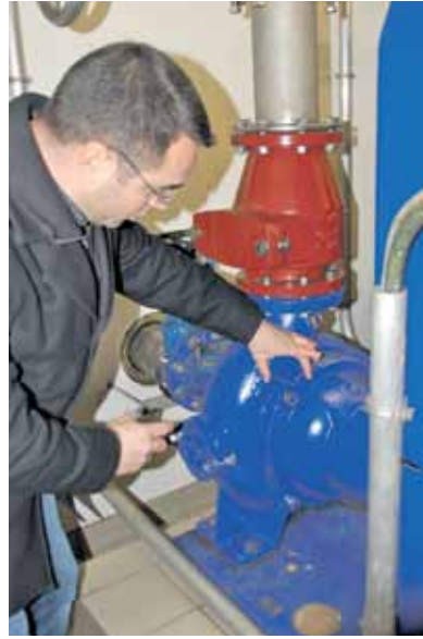
Alexander Pusch inspiziert die erneuerte Pumpe
