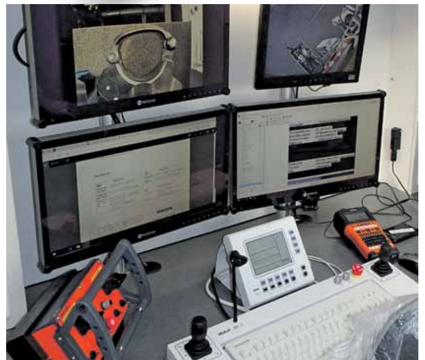
Der Arbeitsplatz des „Inspektors“ im Kanal-TV-Fahrzeug. Er fährt den Kanal-Kamera-Wagen mit der Funkfernsteuerung und dokumentiert die Live-Untersuchung
