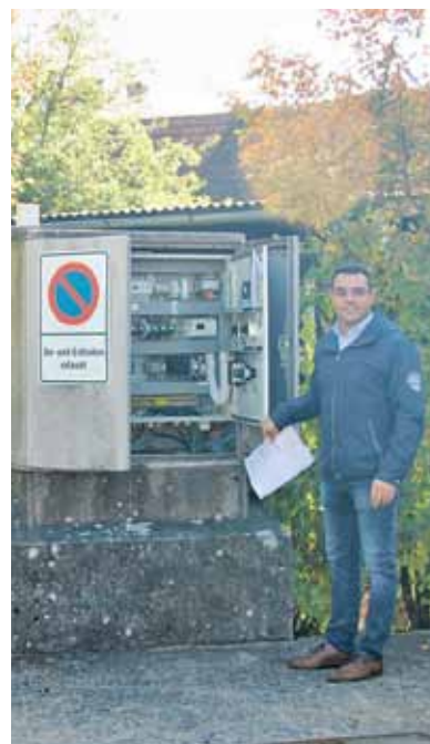
Alexander Pusch gibt Einblick in die Technik der Pumpstation
