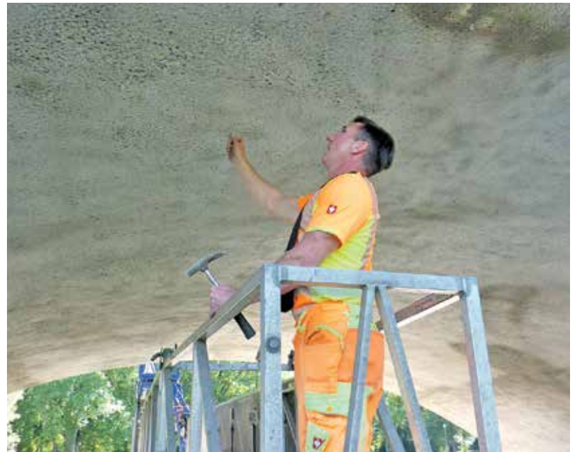
Kritische Stellen werden durch den Prüflingenieur mit Kreide markiert und im Prüfbericht dokumentiert.
