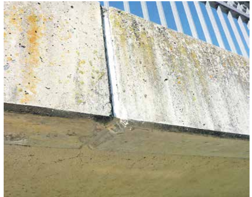
„Risse und Fugen sind kritische Stellen. Denn eindringende Feuchtigkeit gefährdet die Bausubstanz. Ab einer Breite von 0,2 mm spricht man von Rissen“, so Marcel Zimmermann, Leiter des Sachgebietes Infrastrukturerneuerung im Tiefbaureferat.
