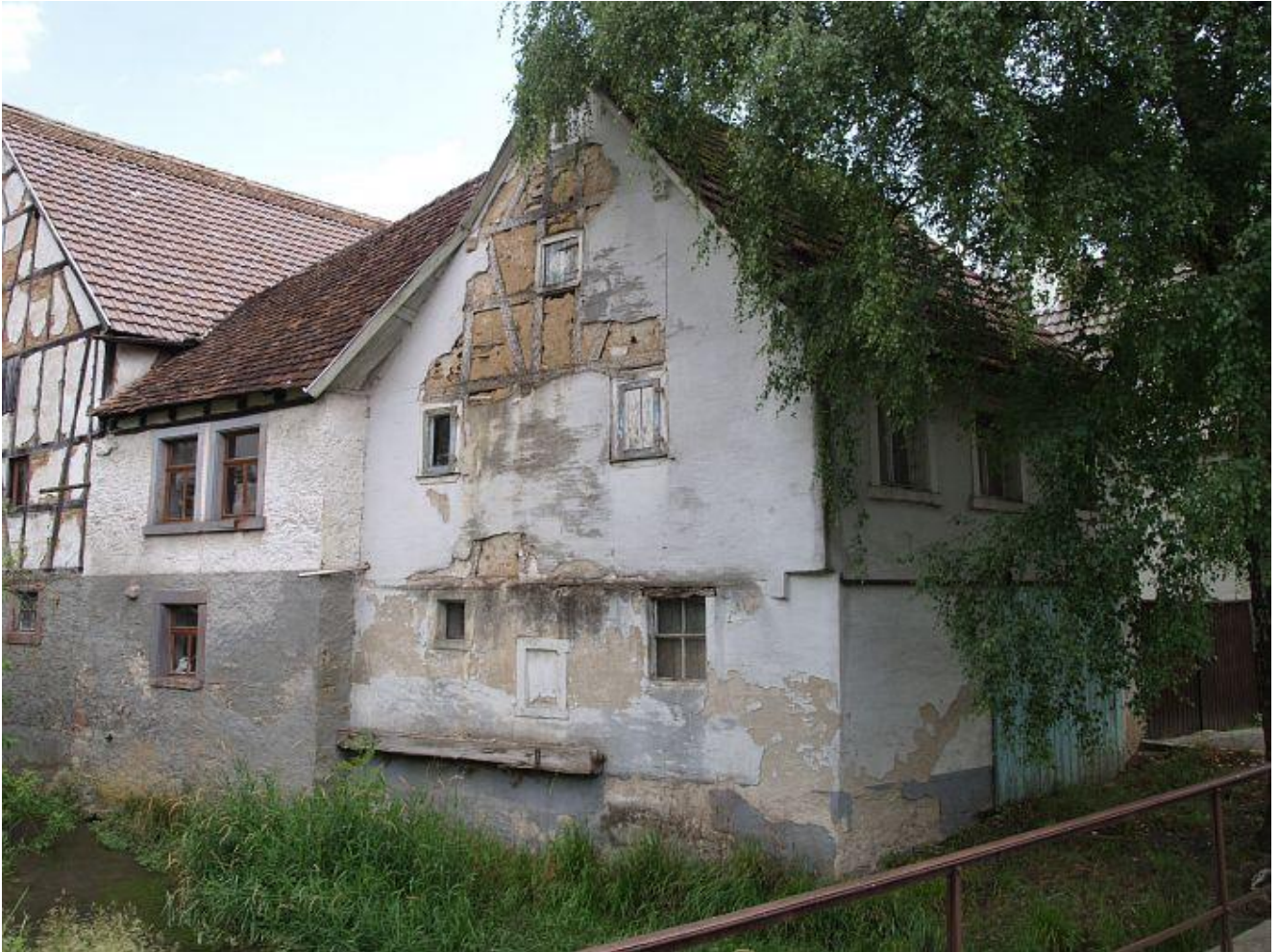
Das ehemalige jüdische Schlachthaus mit der Wohnung des Schocheten © Foto: Dr. Joachim Hahn
