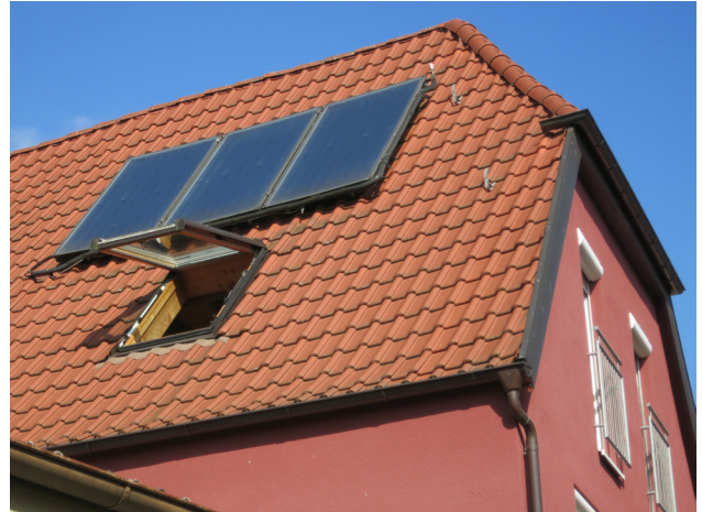
Abb. 62: Beispiel für eine Solarthermieanlage in der Altstadt auf der straßenabgewandten Seite
