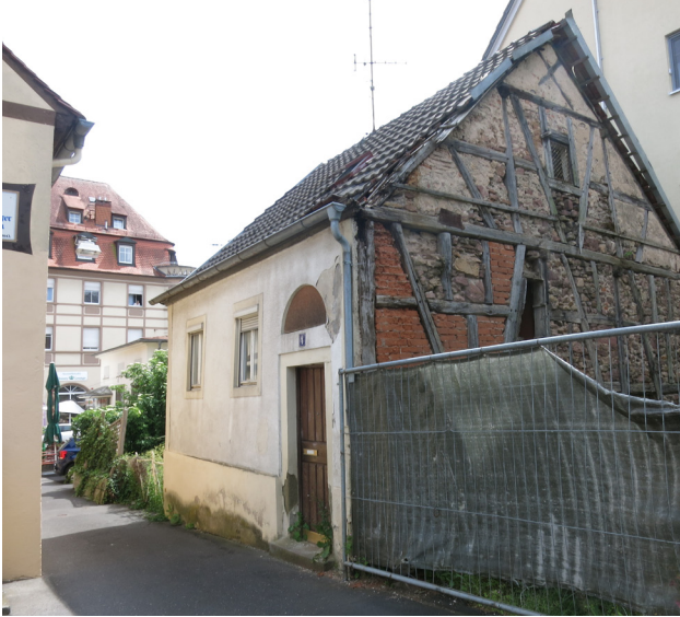
Abb. 50: Beispiel eines leerstehenden und modernisierungsbedürftigen Wohnhauses in der Altstadt Bad Kissingen
